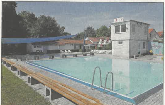
Das Nichtschwimmerbecken des Freibads Goddelau muss aufwendig abgedichtet werden.
