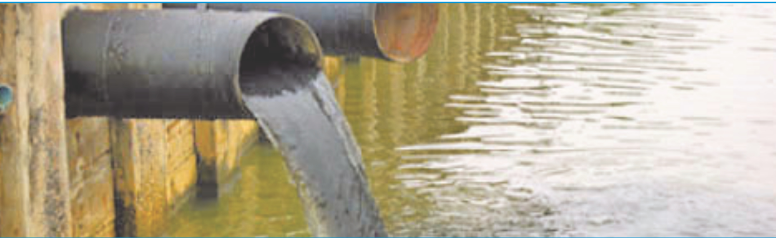
Schmutzwasser wird ungereinigt einem Fluss zugeführt
