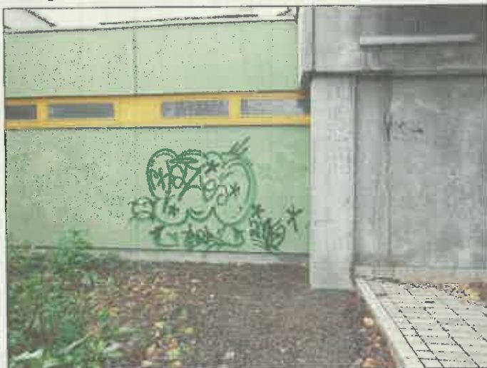
Massive Schmierereien an der Großsporthalle
