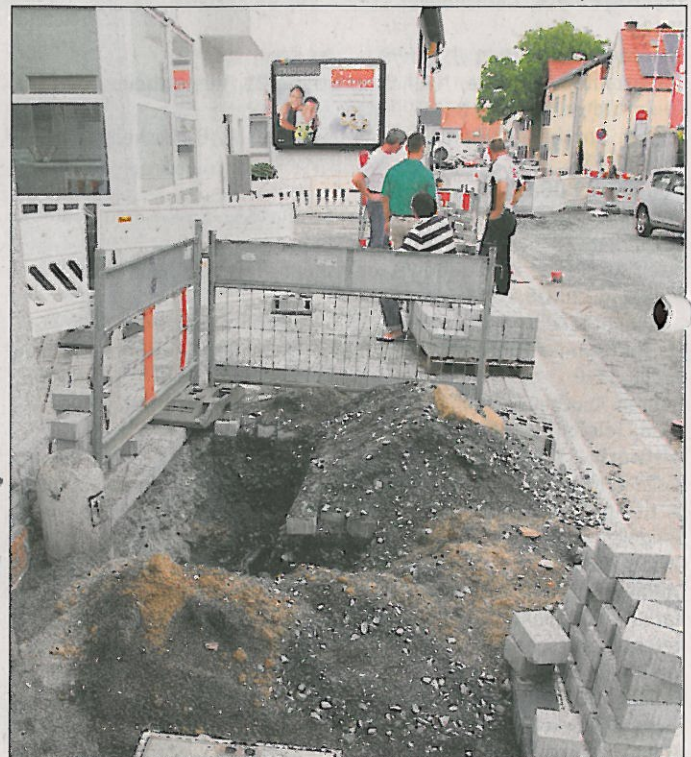
Wenige Stunden nach Fertigstellung wieder aufgerissen
